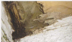
築後わずか8年で天井のベニヤが腐っている。断熱材の施工技術の差ではっきりと効果に表れた一例
